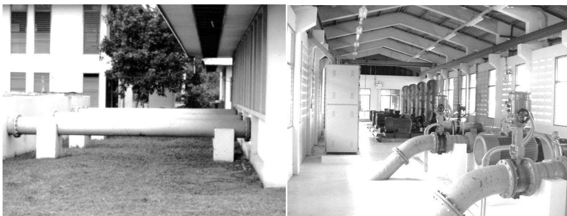
รูปที่ 2-26 โรงสูบน้ำแบบตั้งบนพื้น
